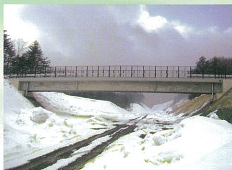
ポストテンション方式単純T桁橋(プレキャストセグメント) 凍結防止による劣化対策
